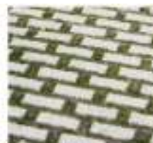
Passage en béton avec ouvertures de drainage
